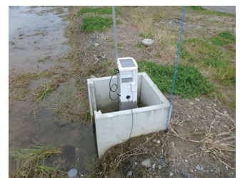
④自動給水栓の設置 （関川用水地区）
