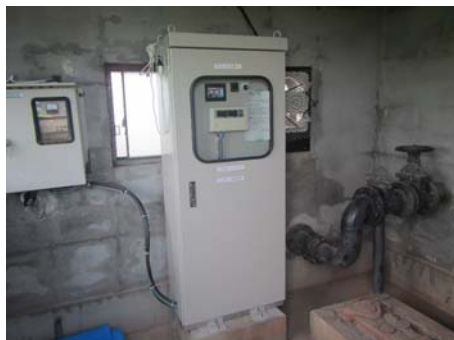
iDAS制御盤の状況
