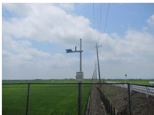
広域監視用 LPWA子局
